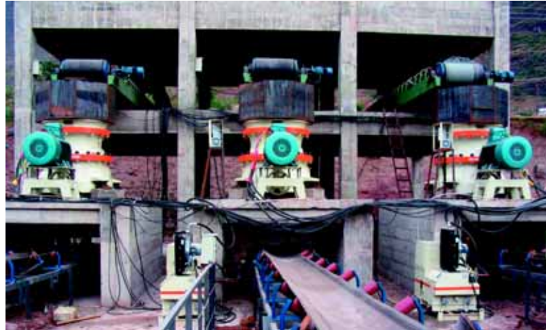
中国四川溪落渡水电站，3 台 GP300S 圆锥破碎机
